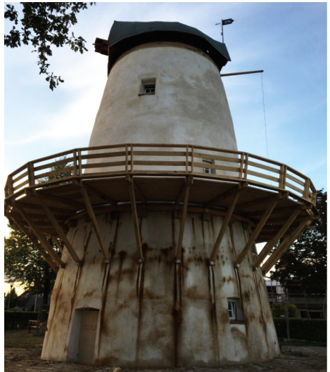
Eichensäureauslauf unterhalb der Galerie.
