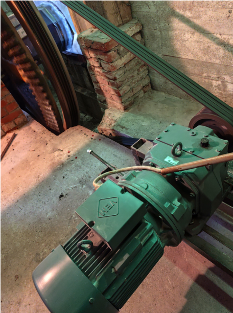
Der 3 KW A-synchrone Generator.
