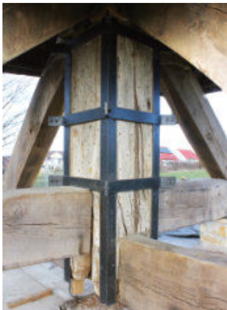
Der 300 Jahre alte Hausbaum war seit mehreren Jahren bereits durch ein Stahlkorsett gesichert, letztlich aber durch Schädlingsbefall in seiner Stabilität so stark geschwächt, dass er nicht mehr zu halten war.
